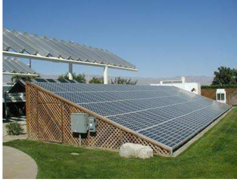
Gambar 1. Pembangkit listrik tenaga surya. (Andrew, Rasional, & Peter, 2015)
